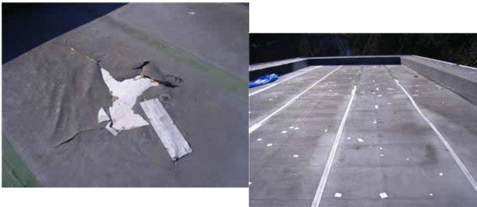
屋上の防水シートが破れ、3階4階の仲間の部屋にも雨水がしみ込んでいます。
