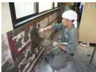
食堂の修繕 ：左官経験のある仲間が手伝ってくれています。
